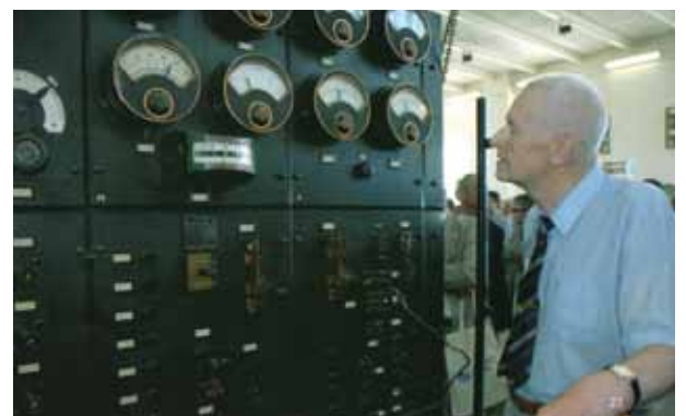
Fig. 4 - Responsável pela estação há muito tempo, Bengt Dagås verifica os instrumentos durante uma transmissão.
