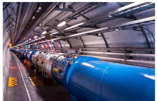
Fig. 1 - uma pequena parte do túnel do LHC onde se veem ímanes supercondutores dipolares que conduzem a órbita dos feixes, a azul, e ímanes quadripolares, a branco, que focam os feixes. (imagem: CERN Genebra)
