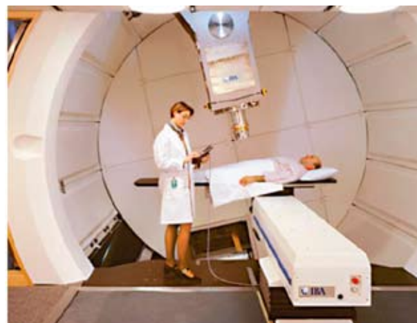
Figura 2 - O exemplo de um gantry para feixe de prótons, do Francis H. Burr Proton Center, Massachusetts General Hospital, Boston, EUA (Cortesia de Ion Beam Applications S.A.).
